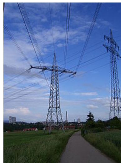
Rys. 2. Słup narożny dwutorowej linii (po lewej) zasilającej stacje trakcyjne
